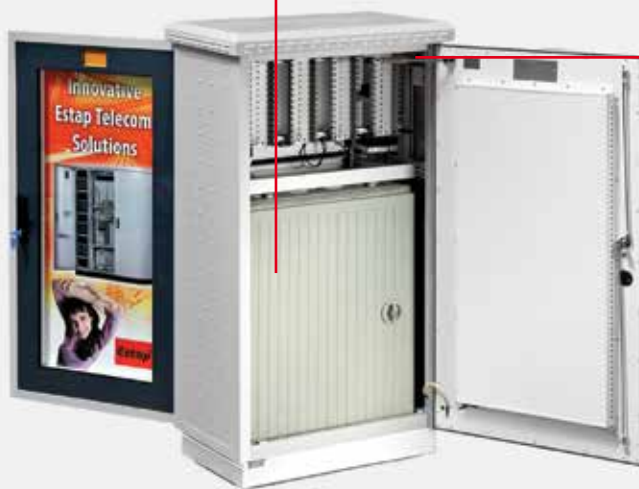
Имеющийся уличный шкаф
